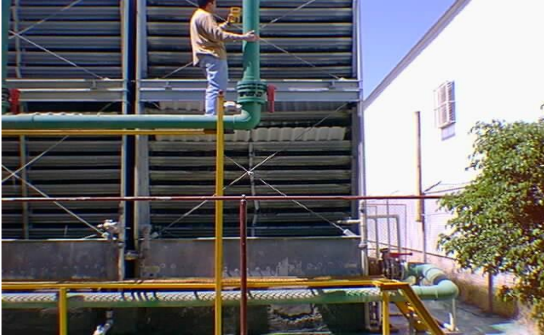
Figura 13. Vista lateral de la torre de enfriamiento.
