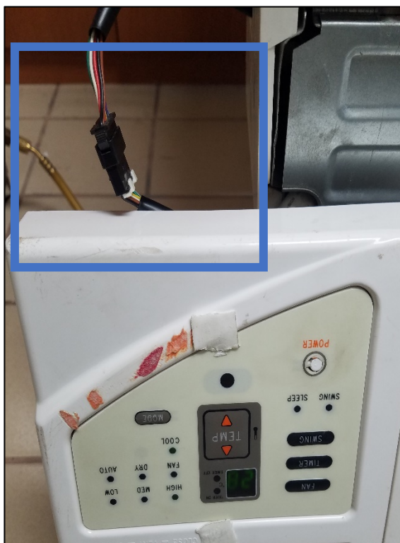
Figura 15. Reconexión de carátula de equipo AC, previo a la recarga de refrigerante.
