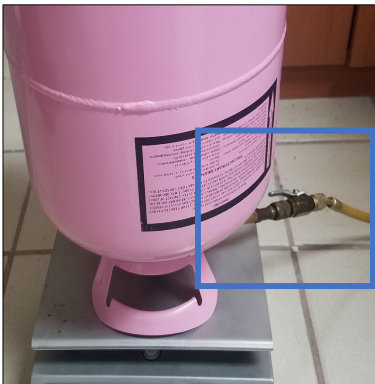
Figura 14. Tanque de suministro posicionado sobre la báscula y manguera de manifold conectada.
