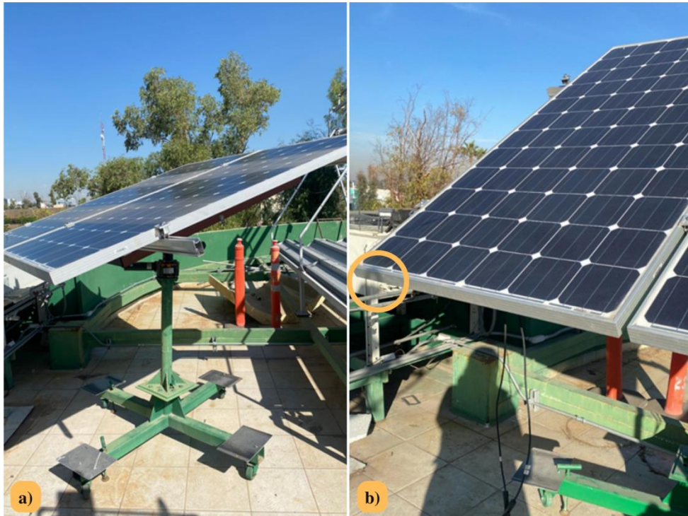
Figura 45. a) Monoposte armado b) Señalización del sombreado sobre un módulo a las 9:00 AM.
