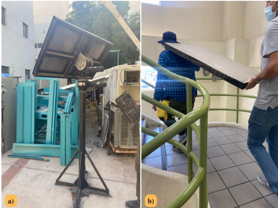
Figura 40. a) Estructura fija que se desmanteló para reutilizar. b) Transportación a la azotea de la parte a utilizar.
