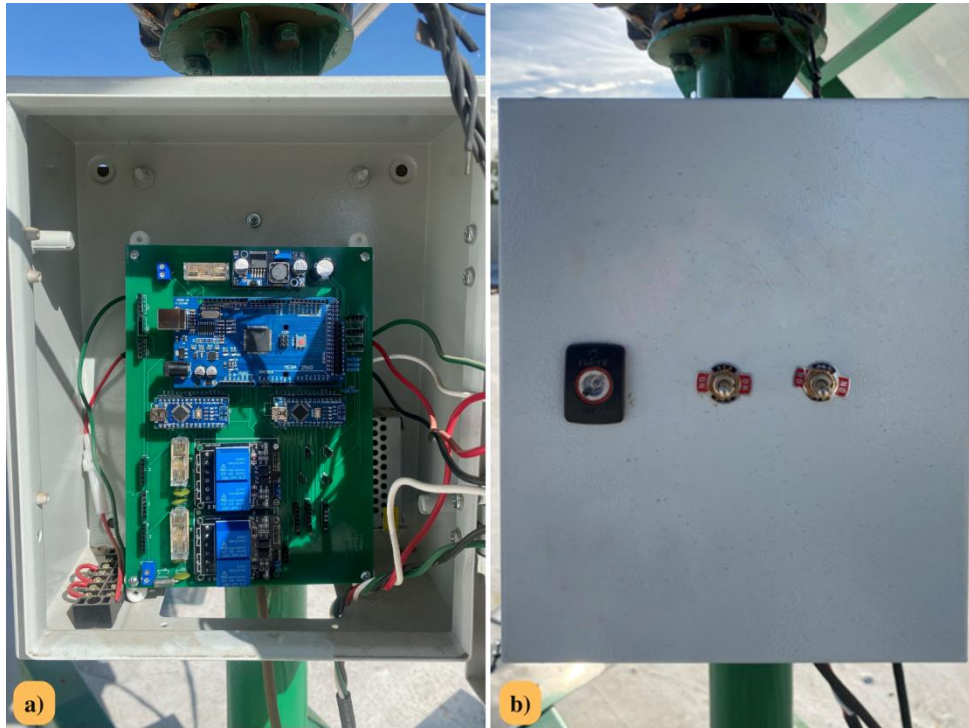
Figura 46. a) Componentes eléctricos y electrónicos dentro del gabinete. b) Vista por fuera del gabinete instalado en el monoposte.
