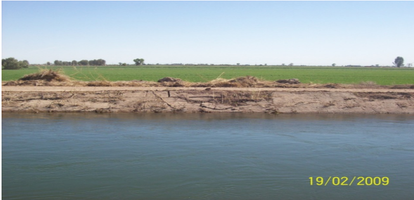
Figura 5.2. Grietas en los taludes del Canal Independencia en km 20+210.
