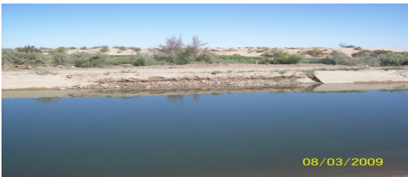
Figura 5.3. Grietas en los taludes del Canal Independencia en km 37+993.
