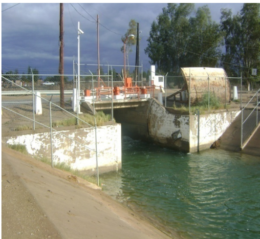
Figura 4.2. Bocatoma Norte Canal Independencia derivado del Canal Alimentador Central.
