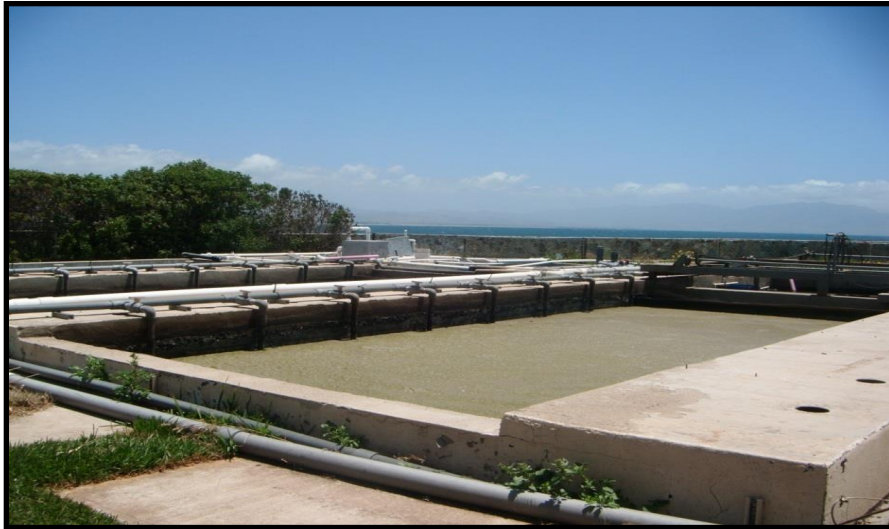
Fotografía 1: Tanque de aireación
