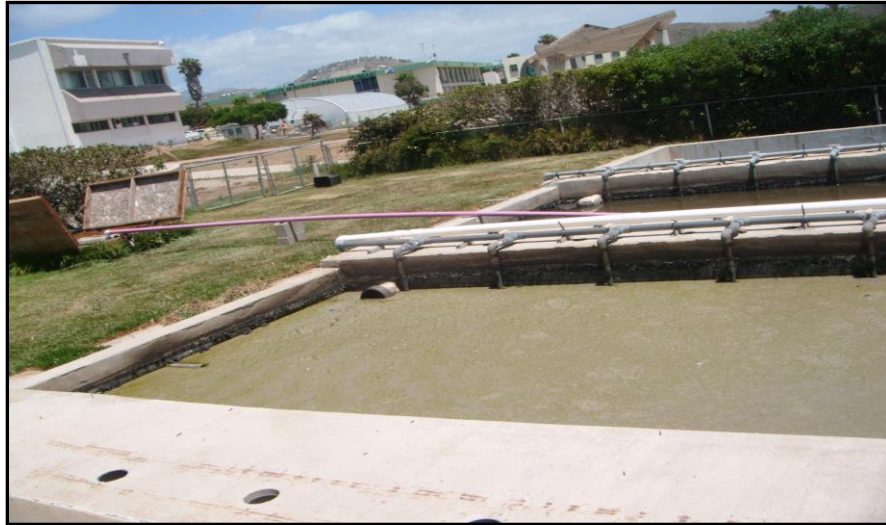
Fotografía 3: Tanque de aireación 2
