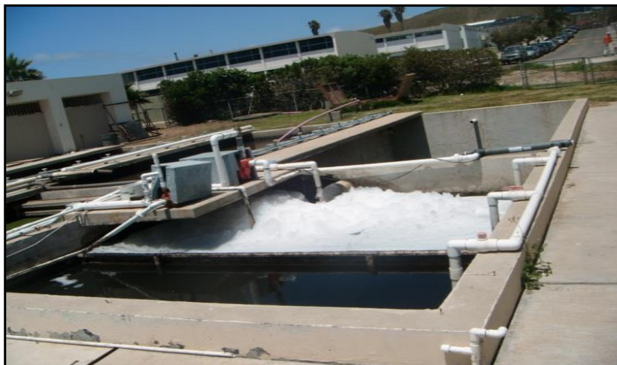
Fotografía 2: Tanque de desinfección
