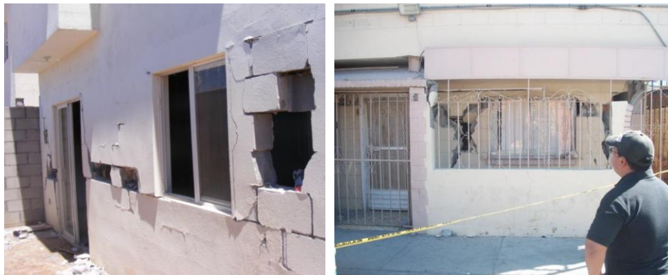
Figura 2.10. Daño de viviendas de mampostería confinada mal construido en el terremoto de Mexicali BC de 2010; esto se considera un rendimiento no dúctil (Martínez & Martínez, 2010).
