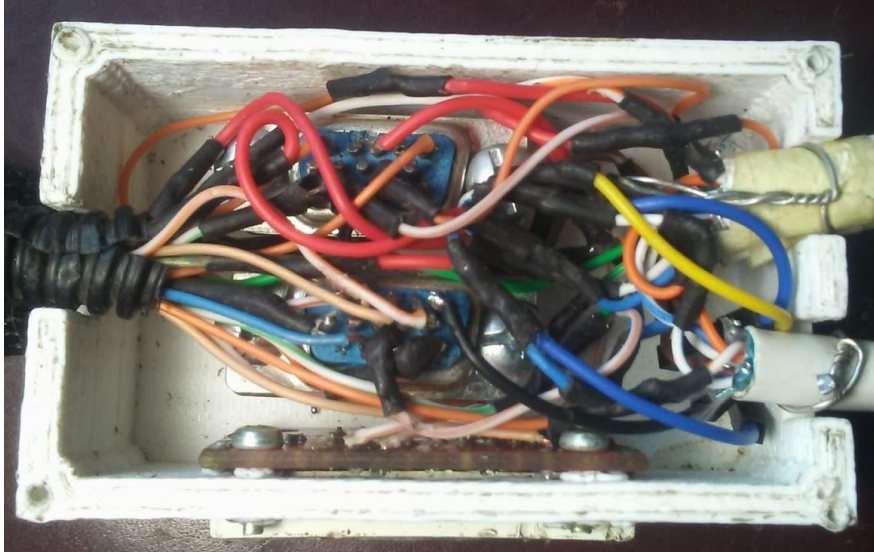
Figura 25. Unidad de cableado y pantalla visto desde arriba.
