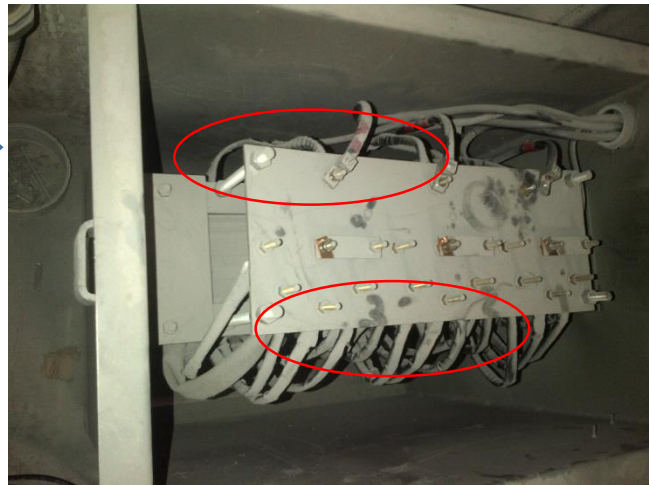
Figura 5.20 Detalles de la revisión del transformador de 50 kVA que alimentaba al equipo de resonancia magnética.
