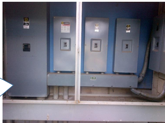
Figura 4.3 (a-f) Detalles descriptivos del sistema eléctrico en media y baja tensión del hospital ISSSTECALI Mexicali.
