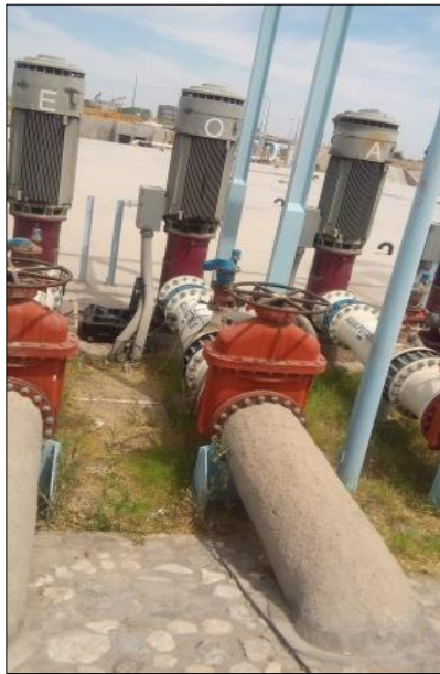
Figura 28. Bomba vertical de la planta de tratamiento de agua bajo estudio. Fuente: elaboración propia.
