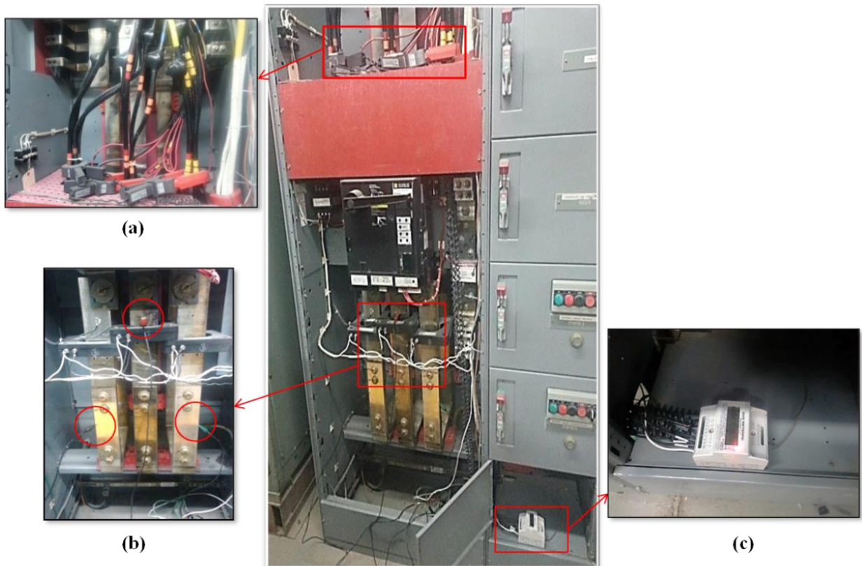
Figura 20. Equipo de medición eléctrica de SisAR ubicado en el centro de carga principal: (a) Transformadores de corriente; (b) cables de voltaje; (c) Medidor eléctrico. Fuente: elaboración propia.
