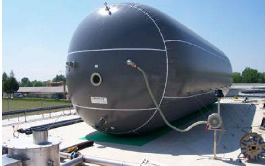
Ilustración 16. Gasómetro plástico conectado a un blower. (CERTIC Energia, 2015).
