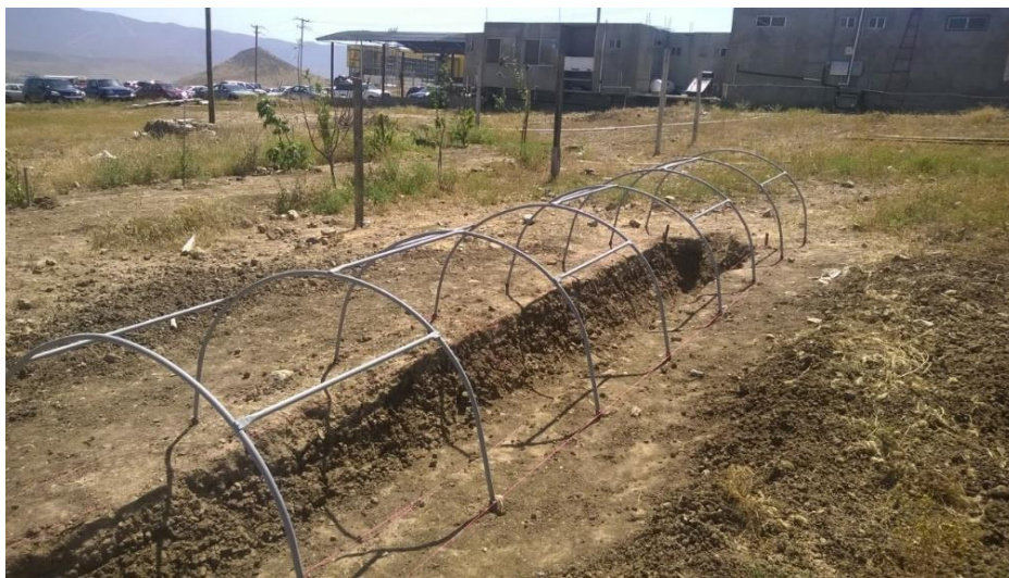
Ilustración 26. Estructura de protección de biodigestor de polietileno (Fotografía del proyecto en construcción).
