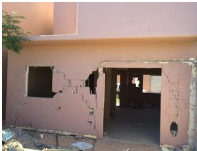
Figura 2.14. Vivienda dañada en sismo de 2010 en Mexicali. Fuente Elaboración propia
