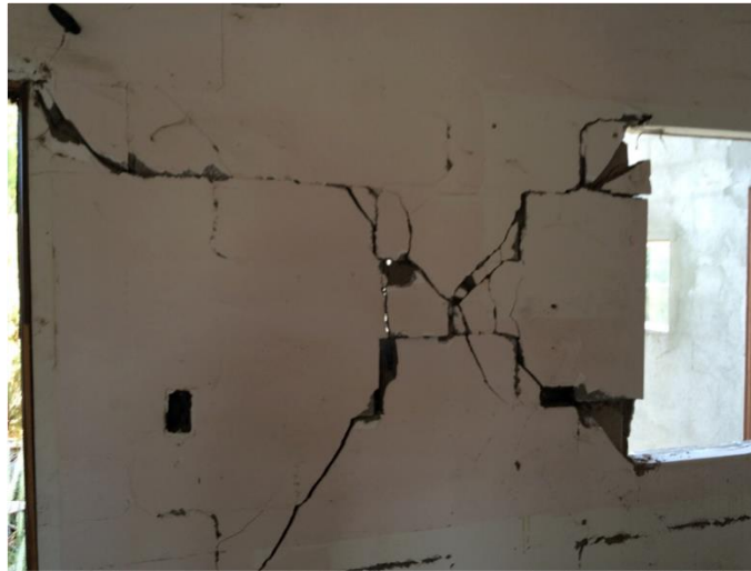
Figura 2.15. Vivienda dañada en sismo de 2010 en Mexicali. Fuente Elaboración propia
