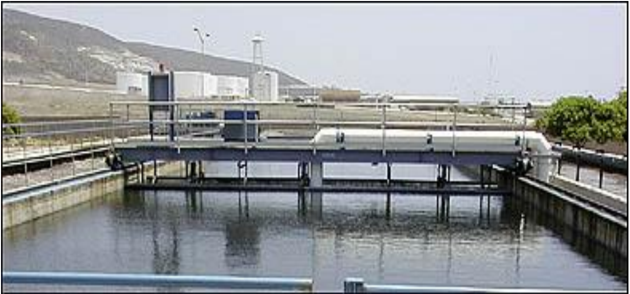
Planta de Tratamiento de Aguas Residuales “El Sauzal”
