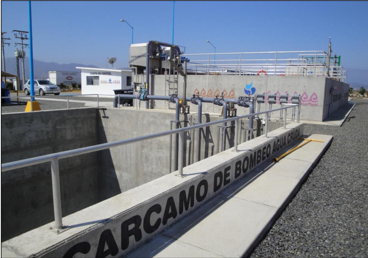
Planta de Tratamiento de Aguas Residuales “Maneadero”
