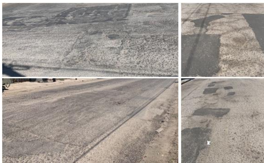
Figura 20. Fallas identificadas en Av. José Antonio Torres.
