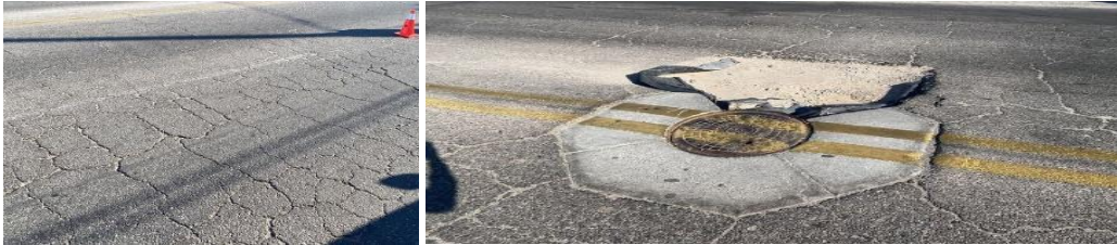
Figura 7. Referencia de PCI “Fallado”.
