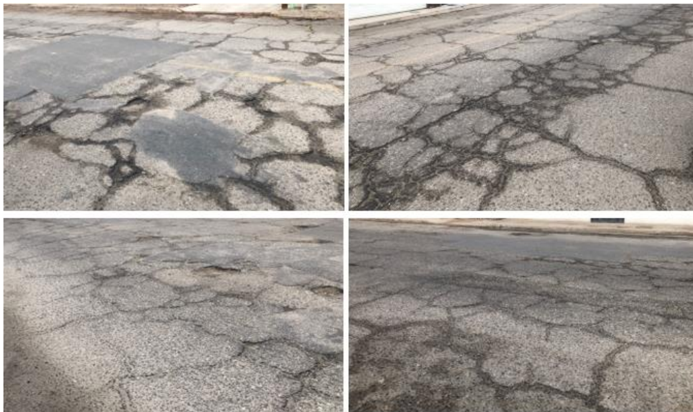
Figura 21. Fallas identificadas en Av. Monclova
