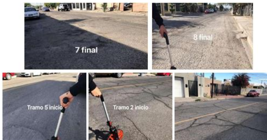
Figura 18. Fallas identificadas en Av. José Joaquín
