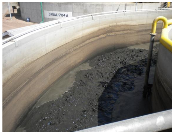
Figura 6. Estabilización de lodos por aireación en Espesador.
