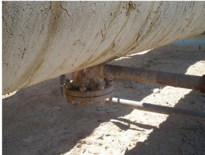
Figura 4.10 Trampa de condensados
