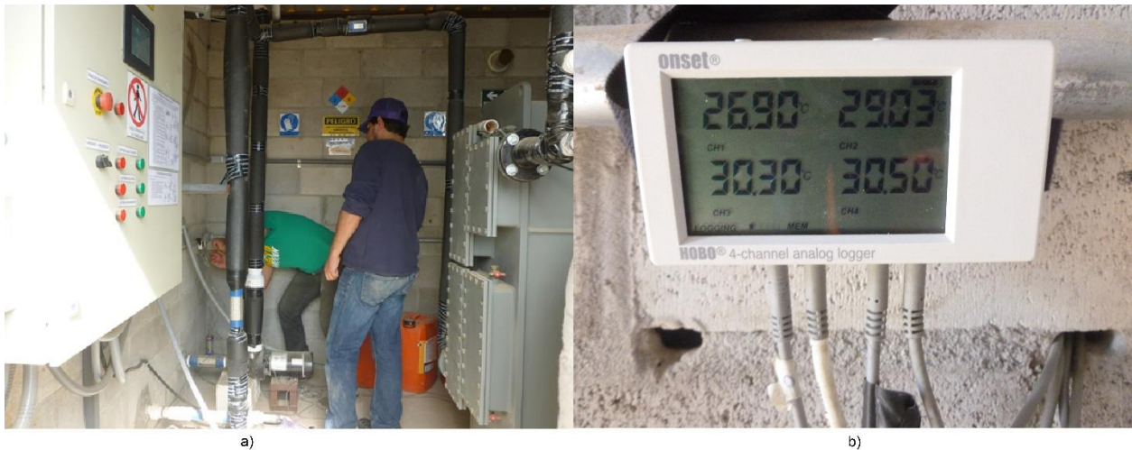
Figura 23. a) Colocación del adquisidor de datos en el cuarto de control del SAATEP. b) Adquisidor de datos puesto en marcha.
