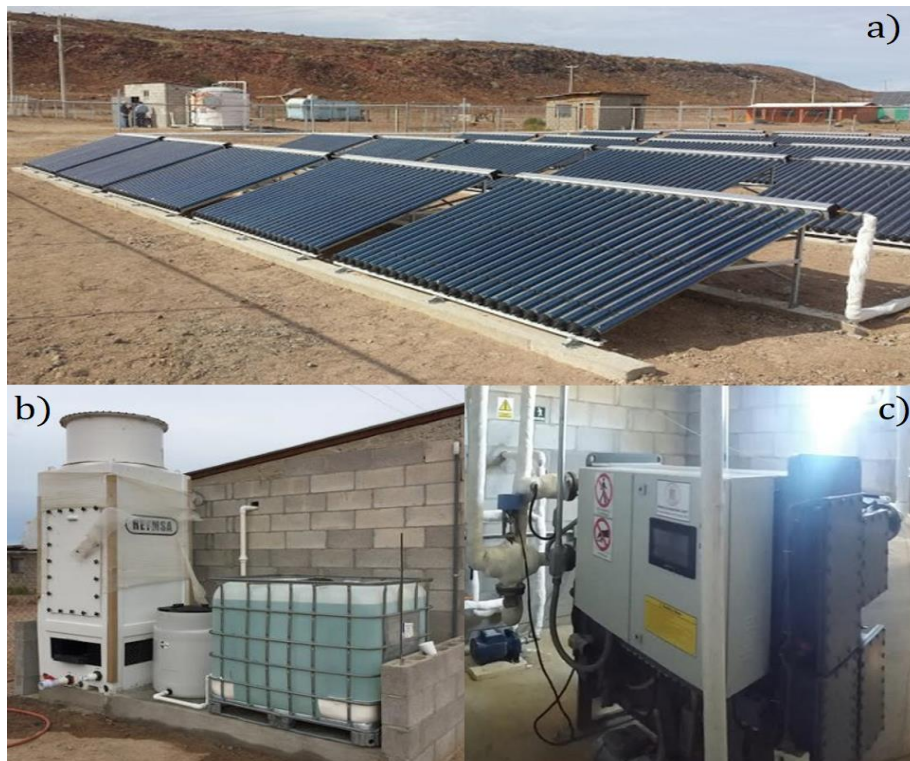
Figura 12. Sistema de A/C termosolar de la escuela de Puertecitos a). Subsistema de captación y almacenamiento de energía solar térmica, b). Torre de enfriamiento y c). Unidad de enfriamiento por absorción. (J.A. Aguilar-Jiménez et al., 2020)
