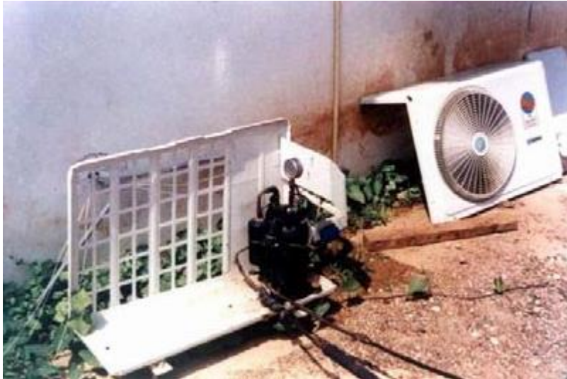
Figura 4. A/C tipo Split modificado para condensar en el subsuelo (Permchart & Tanatvanit, 2009).
