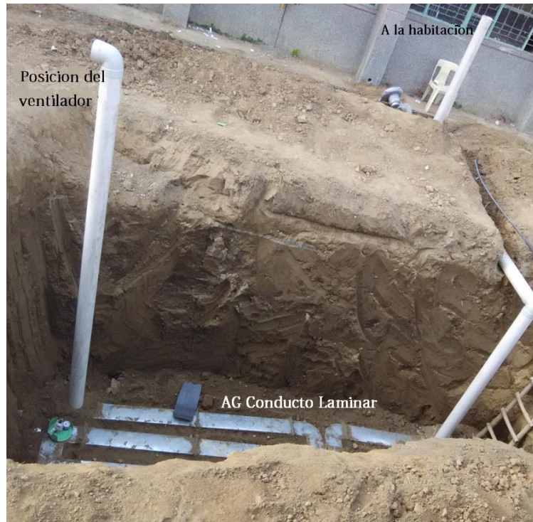
Figura 2.- Instalación de EAHE (Modificado de Singh y Singh, 2015)
