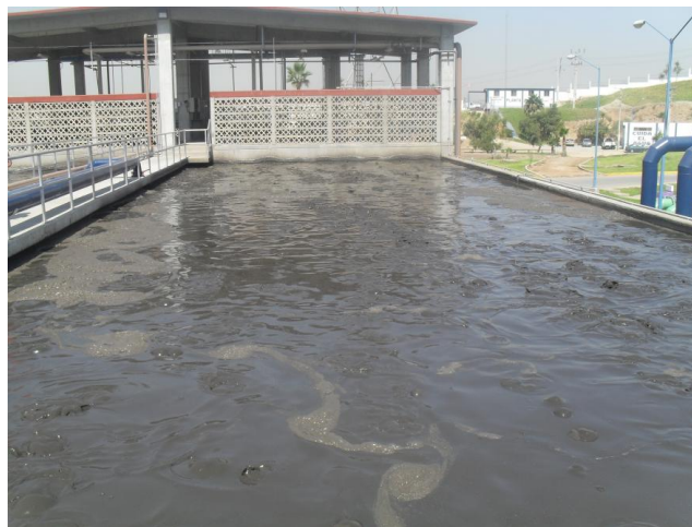
Figura 16. Digestor de lodos.
