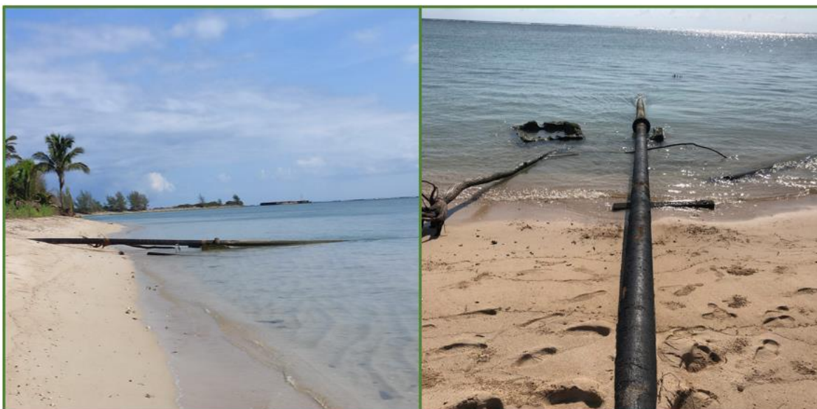
Figura 4.9. Ductos de PEMEX presentes en la zona de playa de la Isla Lobos
