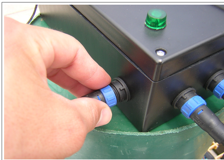
Figura 46. Conexión del cable de salida hacia el gabinete (S/A).
