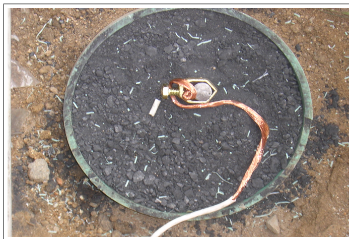
Figura 51. Tierra física instalada cerca de la plataforma de investigación.
