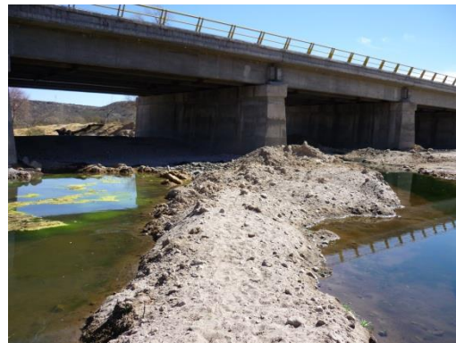
Figura 16 Modificación del cauce del río por obras de ampliación en el puente Atotonilco.
