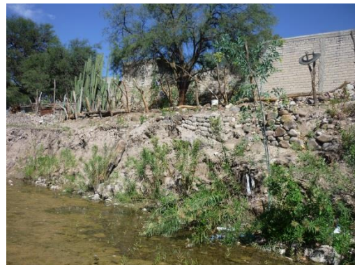
Figura 12 Erosión y asentamientos humanos sobre el cauce del río en Miguel Hidalgo.
