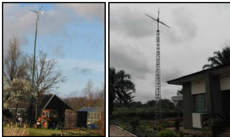
Figura 4.23: Aerogeneradores de baja potencia instalados en zonas aisladas.
