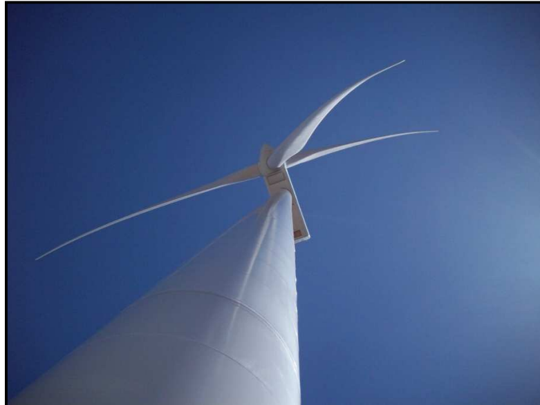
Figura 4.21: Turbina que aprovecha la energía cinética del viento, con una capacidad de 2 MW. La Rumorosa I, Baja California.
