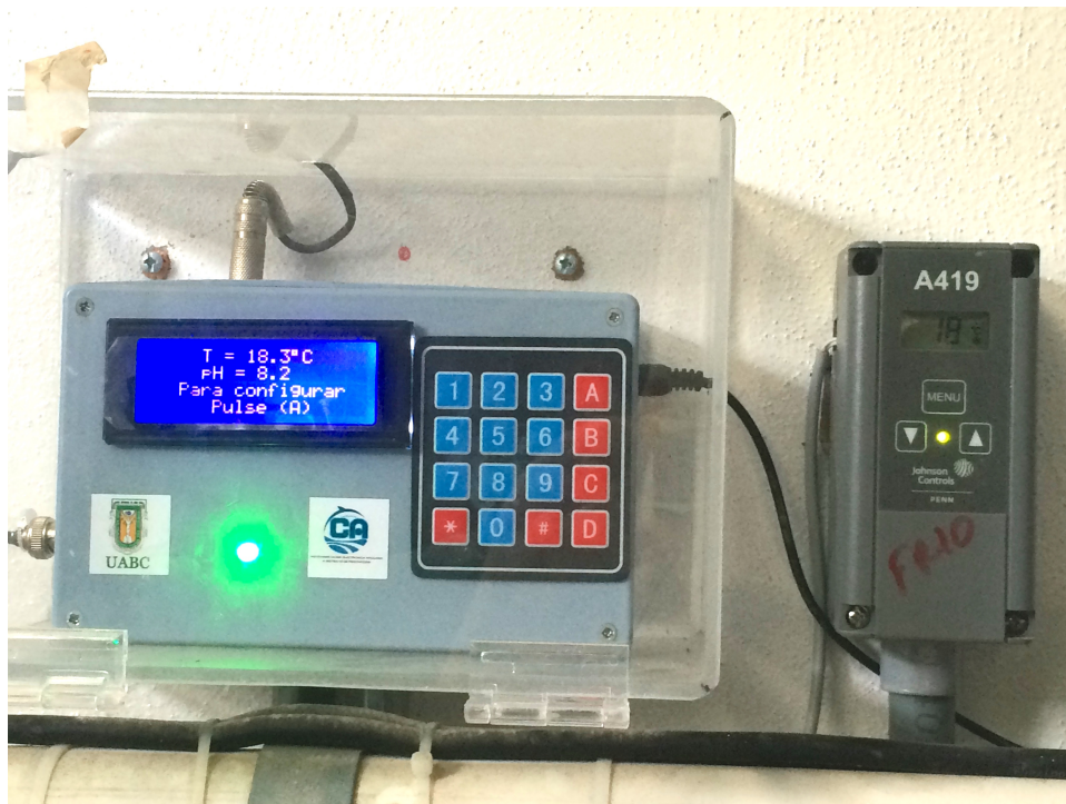
Figura 51: Prototipo del medidor de pH y temperatura instalado en la empresa Productos Oceánica.
