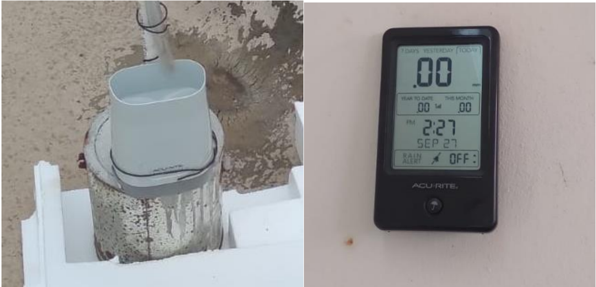
Figura 47. Pluviómetro y monitor fijados en planta de tratamiento UABC Ensenada Campus Sauzal
