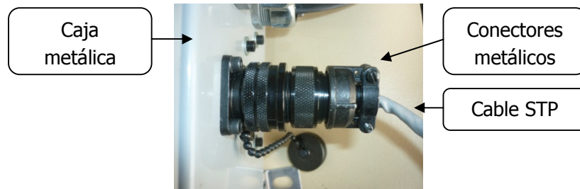
Figura 50. Conexión entre cable STP y caja metálica.
