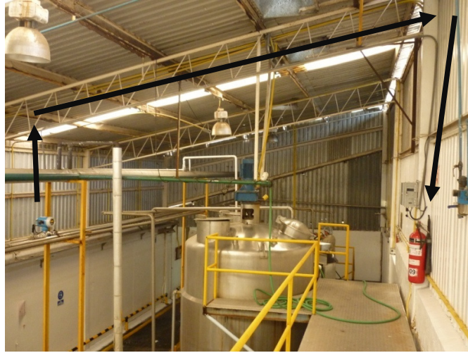
Figura 87. Cableado entre medidor electromagnético e instrumento.
