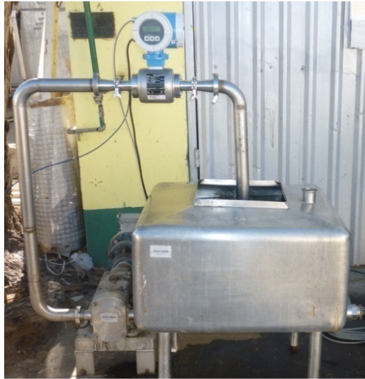
Figura 132. Circuito de tubería para pruebas en campo.
