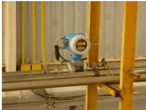
Figura 82. Medidor de caudal en tubería del puré de tomate.
