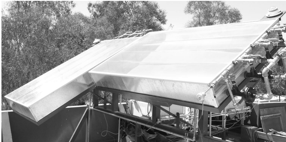
Figura 2. Colectores solares CPC en la plataforma solar del CEENER
