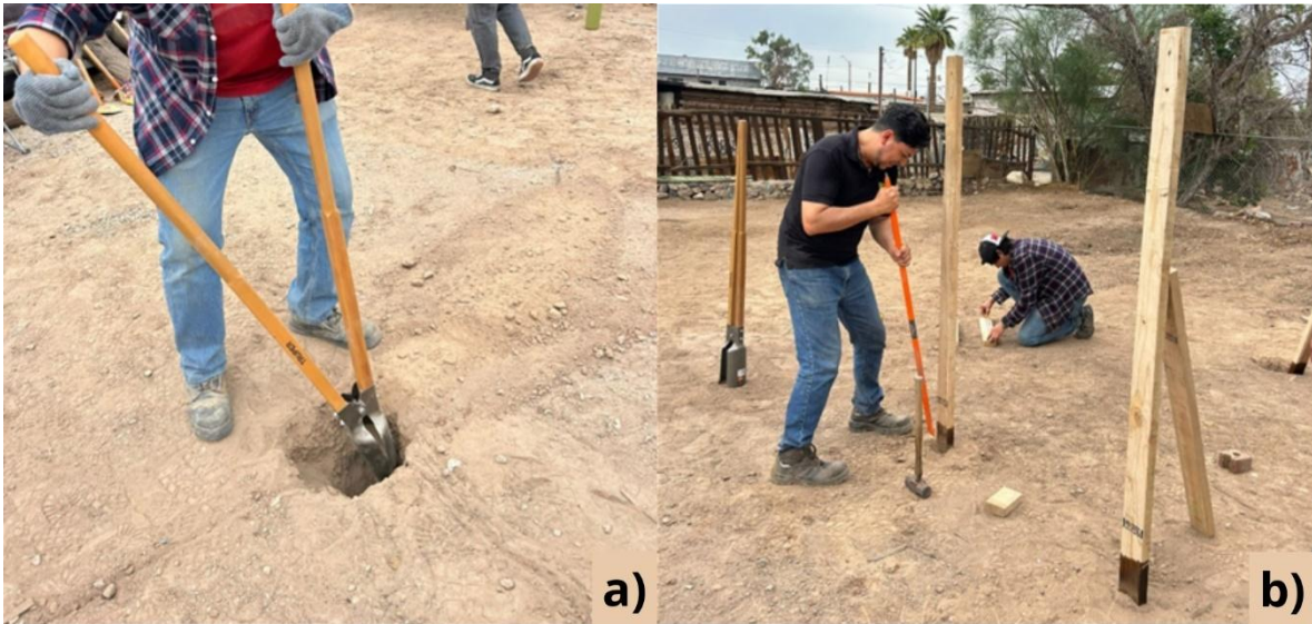
Figura 59. Preparación del terreno. a) proceso de perforación del plano; b) instalación de los barrotes base de madera.
