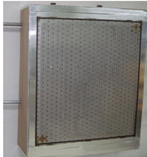
Figura 4.4 Intercambiador de calor instalado
