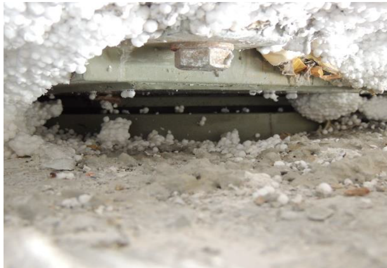
Figura 4.10: Protección contra intemperismo a base de espuma de poliuretano.
