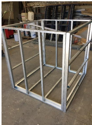
Figura 17. Armado de estructura a base de postes y canales metálicos. Fuente: Elaboración propia.
