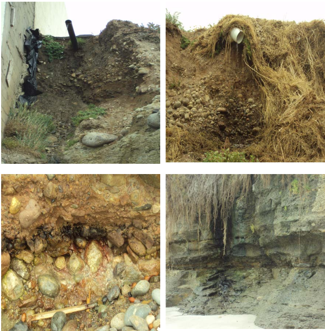
Figura 39. Drenaje inadecuado en lo franja costera del Sauzal. Se muestran la forma en la que los habitantes se deshacen de los desechos líquidos y la humedad que esto genera en los cantiles.
