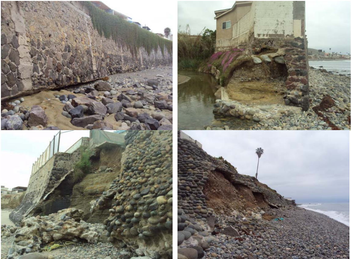
Figura 38. Ejemplos de los principales problemas que presentan los muros del Sauzal.
