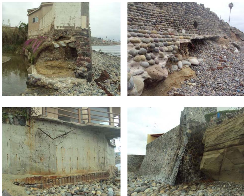
Figura 22. Principales problemas que presentan los muros de El Sauzal. Se observa erosión lateral (esquina superior izquierda), erosión en la base (esquina superior derecha), varillas oxidadas (esquina inferior izquierda) y drenaje inadecuado (esquina inferior derecha).
