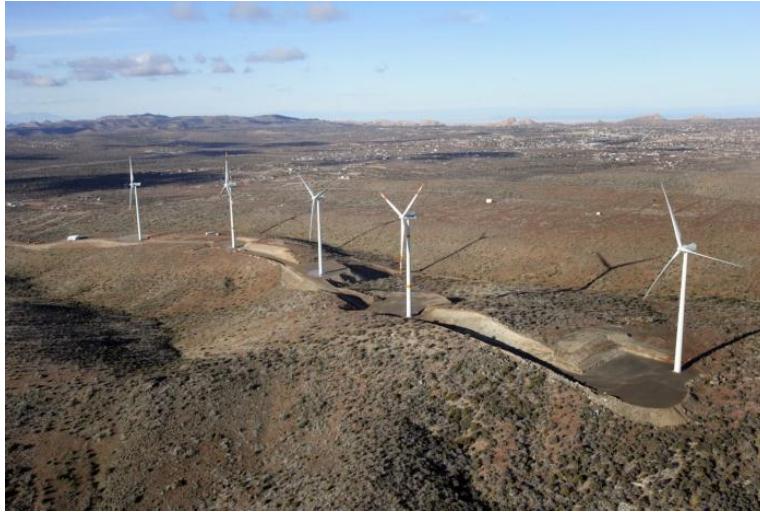
Fig. 15 Parque eólico La Rumorosa con 10 MW instalados
