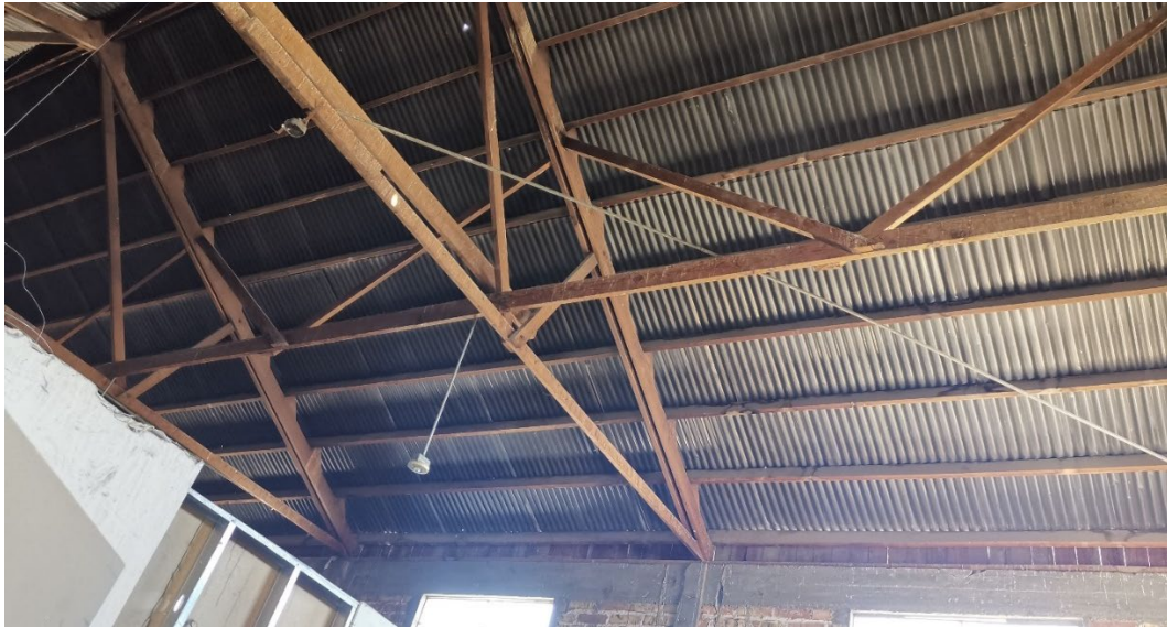
Figura 155. Imagen interior de galerón a rehabilitar como casa estudio. Mexicali, Baja California, México.
