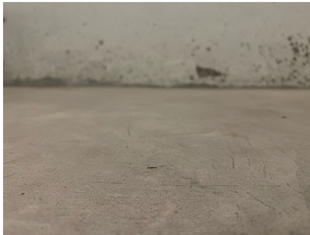
Figura 6.9: Superficie de concreto plano no pulido, con irregularidades controladas, sin hoyos profundos, ni sustancias no reconocidas.
