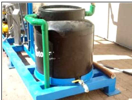
Figura 32. Tanque de recepción y almacenamiento del agua tratada (efluente).
