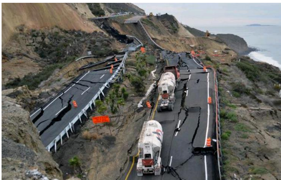
Figura 3. Resultado de los hundimientos en la carretera escénica Ensenada-Tijuana
