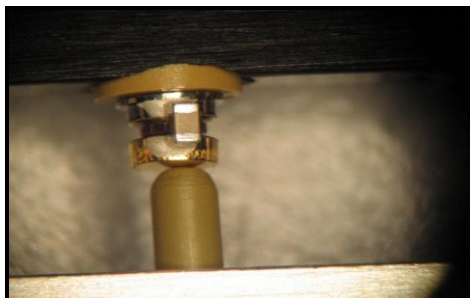
Figura 153. Inspección del capacitor
