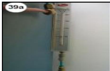
Figura 98.-Medidor de flujo
