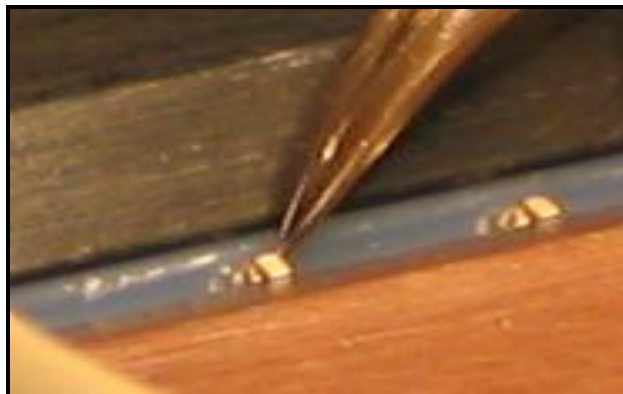
Figura 18.- Acercamiento mostrando la colocación del capacitor
