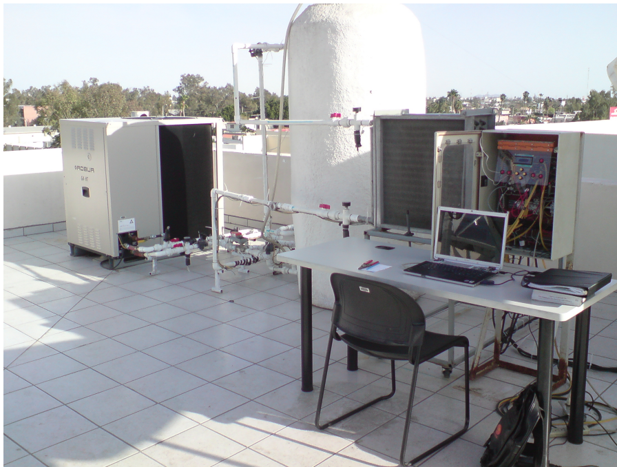
Figura 4.10: Vista panorámica del sistema de aire acondicionado.
