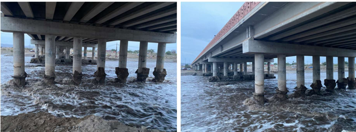
Figura 156: Marco simple en contacto con el flujo del río y daños estructurales
