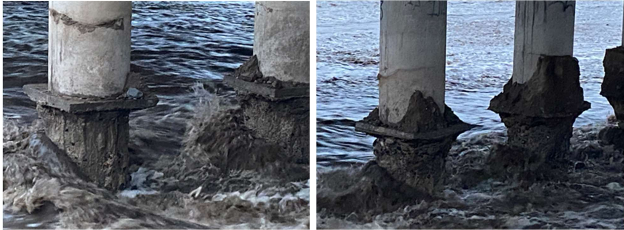
Figura 157: Pérdida del recubrimiento en la base de las columnas en un marco simple central
