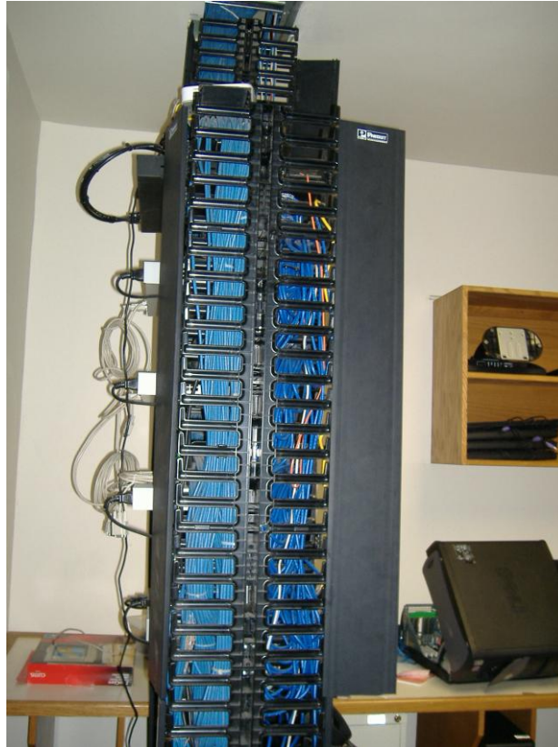
Figura 17: Fotografía de lado del equipo de conexión en el site del segundo piso en el edificio “C” de la FCA.
