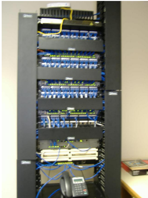
Figura 16: Fotografía de frente del equipo de conexión en el site del segundo piso en el edificio “C” de la FCA.
