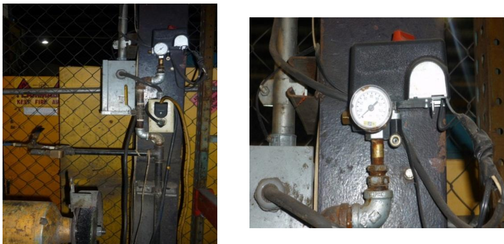
Figura 3.62 Alarma para controlar presión de aire.
