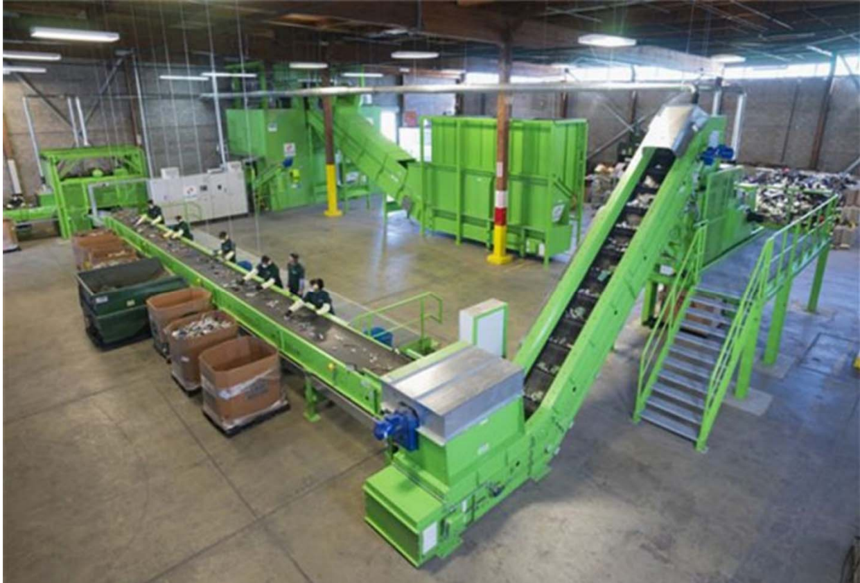
Figura 35. Interior de la planta CEAR, utilizando una máquina de impacto
