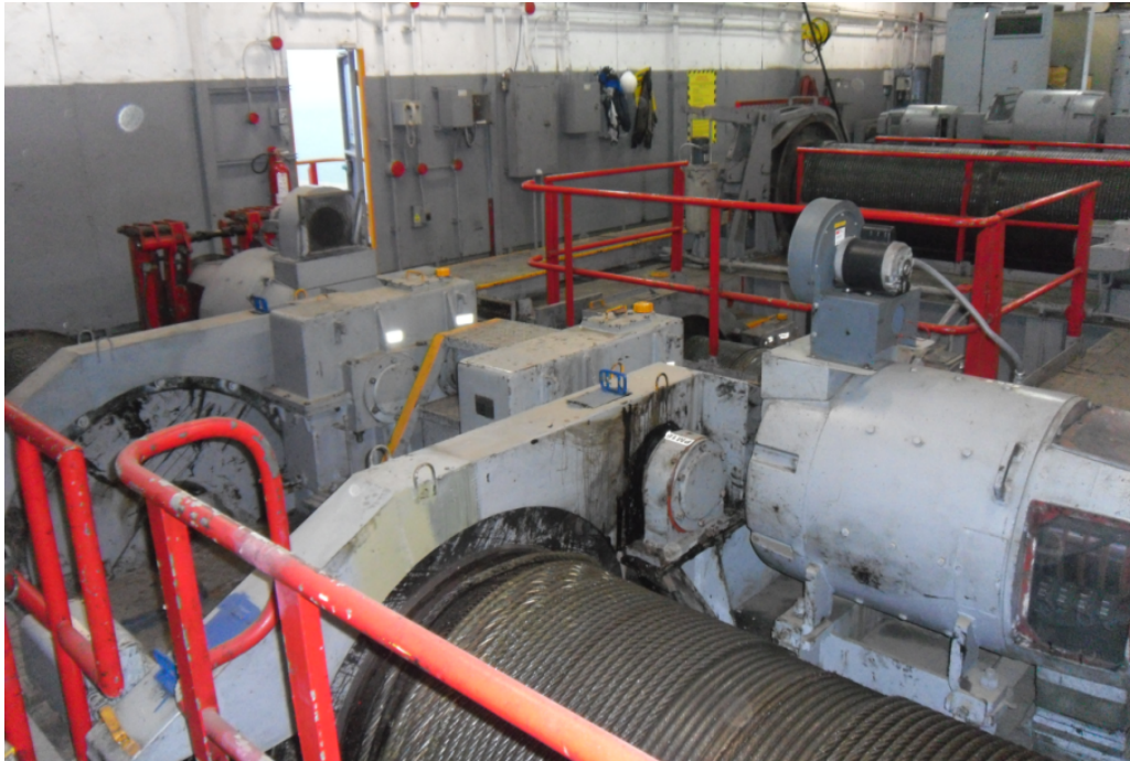
Figura 19. Motores del sistema de Hoist.
