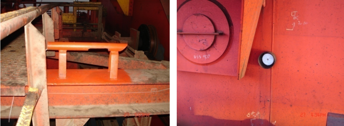
Figura 28. Sensor óptico de posición de Trolley y su reflector.
