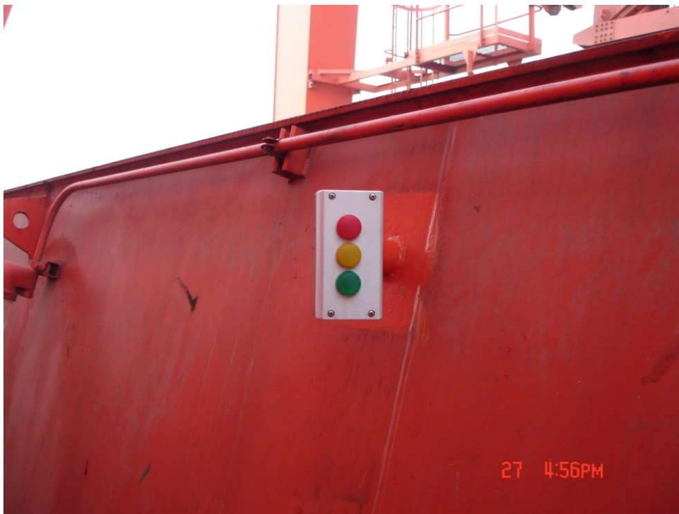
Figura 26. Semáforo colocado en puerta de acceso.
