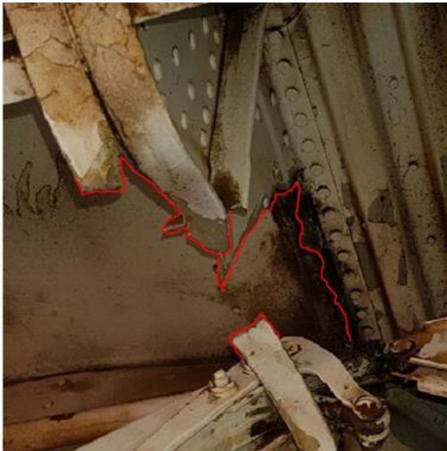
Imagen 39. Vista aumentada y marcada con rojo en la sección de ruptura.
