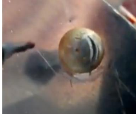
Imagen 58. Cabeza dañada por mal acomodo de la buterola
