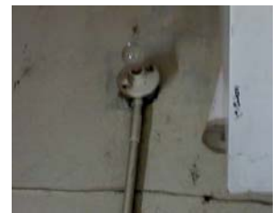
Instalaciones eléctricas en mal estado y viejas
