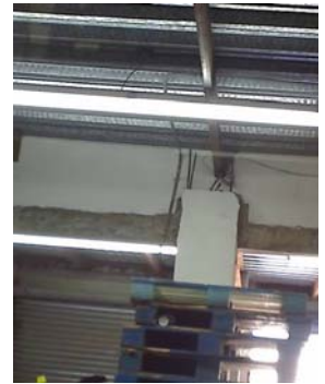
Instalaciones eléctricas en mal estado y viejas
