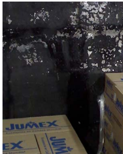
Paredes en mal estado (trasmite agua)
