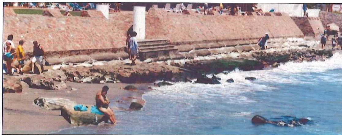
Figura-7. Pared marina mal construida y uso erróneo de bolsacretos para contener el arribo del oleaje extremo (abril 2003), playa "El Salado".
