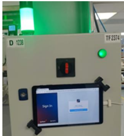
Figura 4.11 Imagen de referencia de sistema ANDON instalado en EMPRESA CASO DE ESTUDIO
