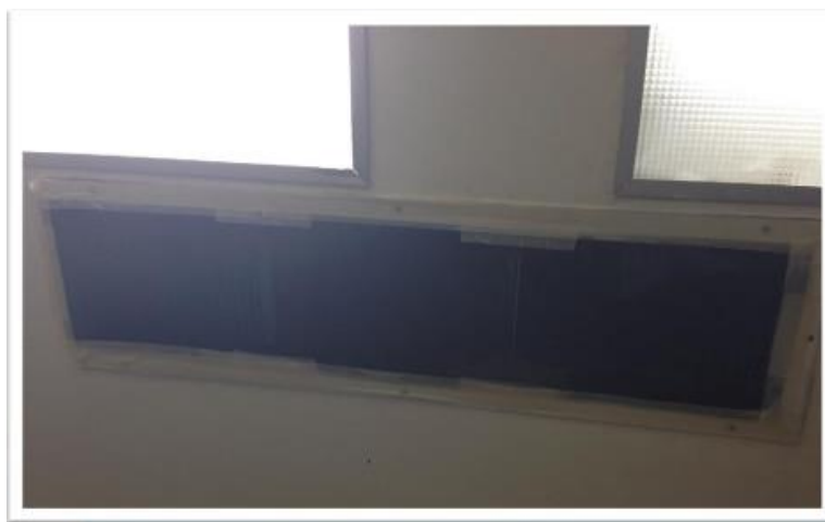
Figura 5. Conductos de ventilación
