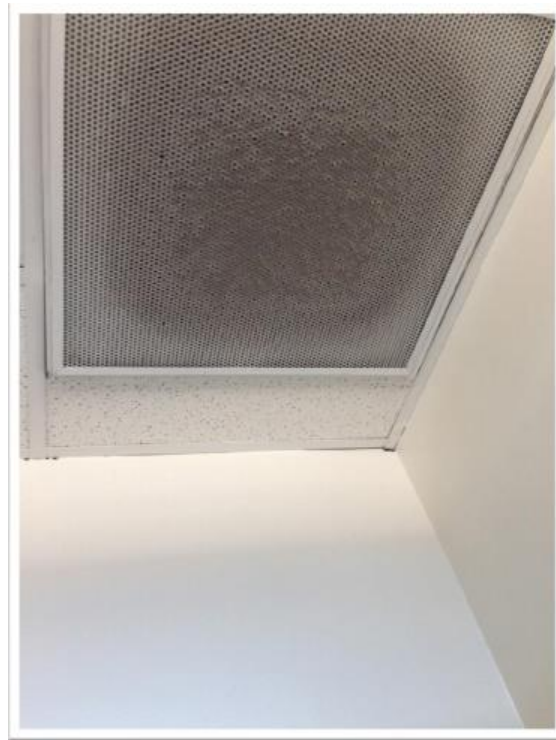
Figura 4. Conductos de ventilación
