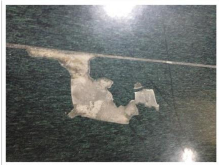
Figura 2. Piso de quirófano
