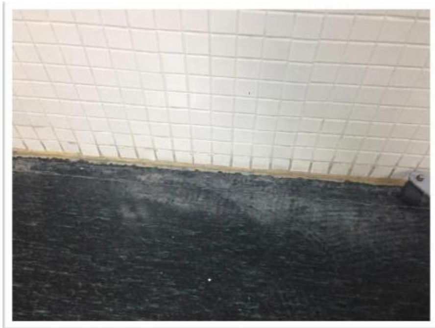
Figura 3. Piso de quirófano
