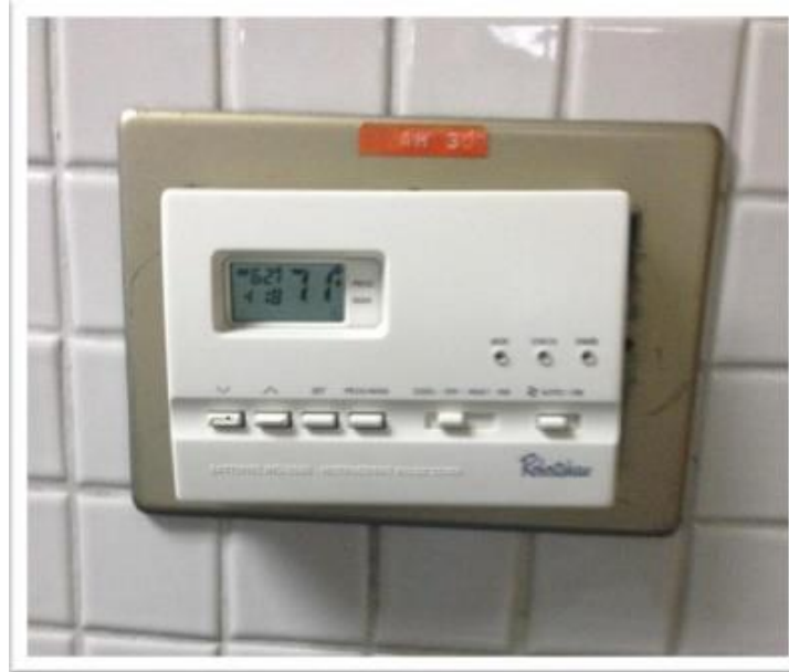
Figura 6. Sistema de control de temperatura y humedad
