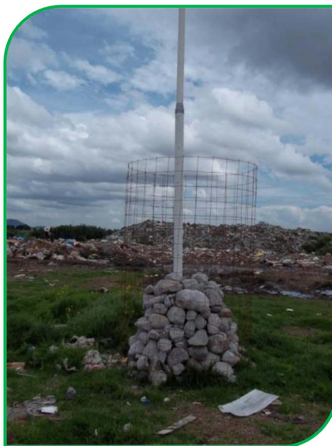
Figura 4.21 Pozo de venteo del vertedero de Mexicaltzingo.
