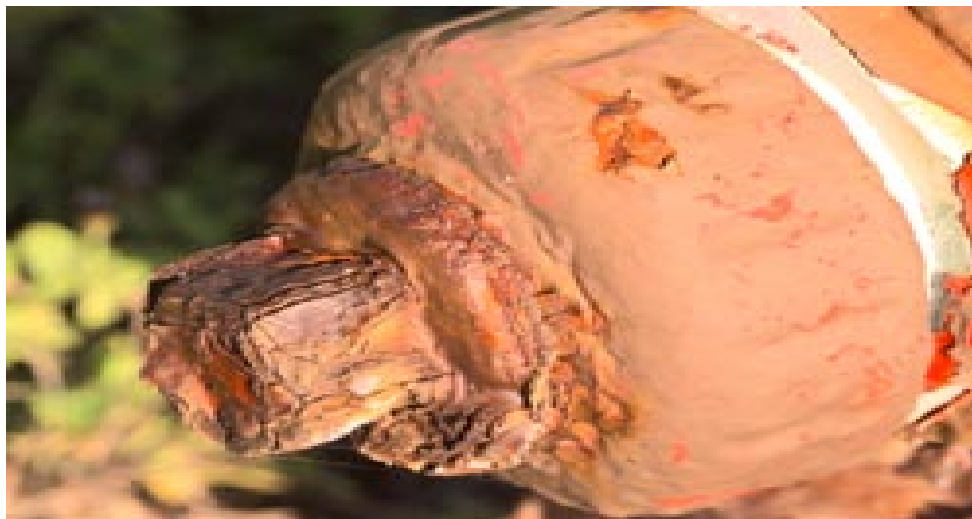
Figura 2.10. Corrosión por exfoliación en tanque de acero inoxidable aleado con aluminio. Fuente. http://corrosion.ksc.nasa.gov/intercor.htm
