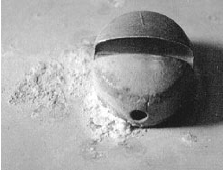
Figura 2.6. Corrosión galvánica en la cabeza de un tornillo de acero inoxidable sujeto a una lámina de aluminio.
