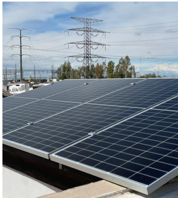
Imagen obtenida de recursos propios, instalación efectuada por Solarsol
